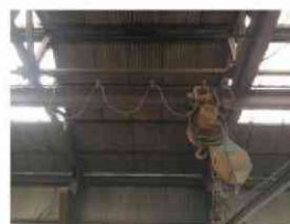
天井クレーン 残置物 動作未確認
